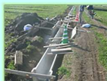
老朽化した用水路の補修
